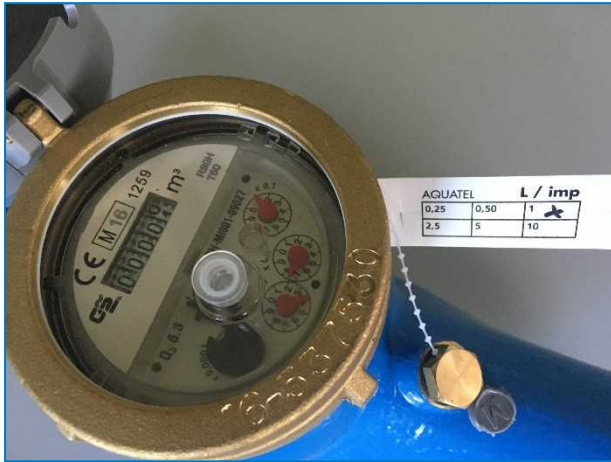
Water meter (Medidor de agua)
