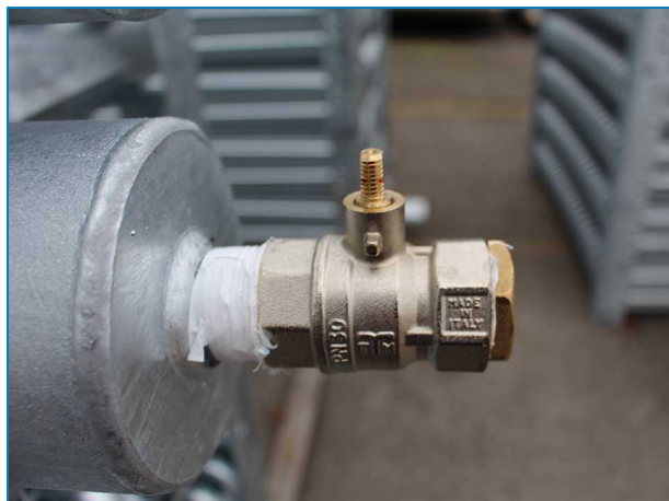
Övre slingkoppling med övertrycksventil på kondensorer.
