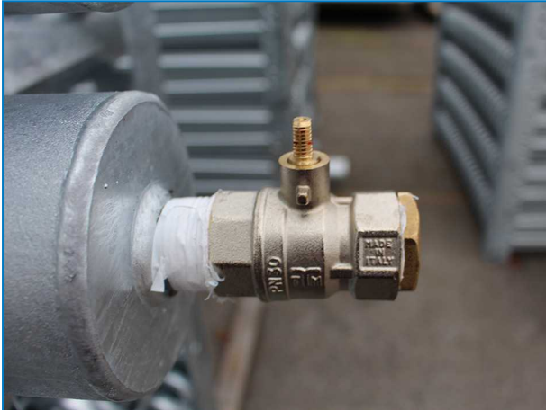
Bovenste batterijaansluiting met drukaflaatklep op condensors.
