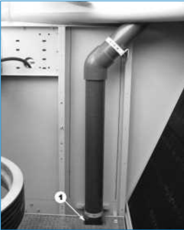
Pompleidingen plenumsectie binnenin
