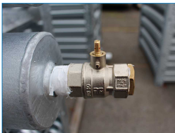
Соединение верхнего теплообменника с клапаном, стравливающим давление, на конденсаторах.
