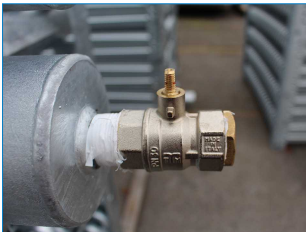
Oberer Rohrbündelanschluss mit Überdruckventil auf Verdunstungsverflüssigern.
