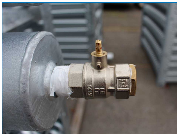
Oberer Rohrbündelanschluss mit Überdruckventil auf Verdunstungsverflüssigern.
