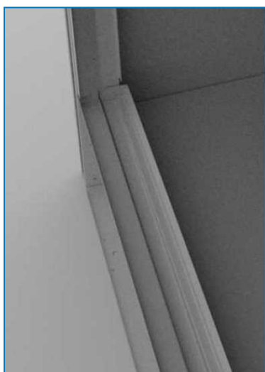
Gouttière de recueil de l'eau
