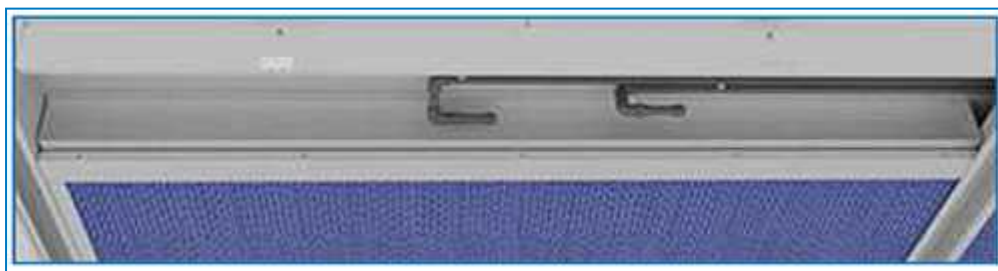
Distribution d'eau du pré-refroidisseur
