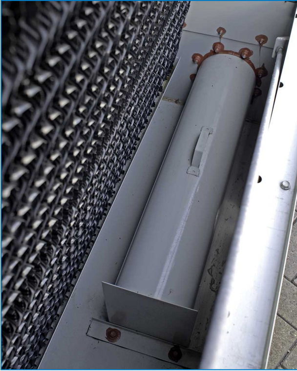
Bassin d'eau froide et tamis
