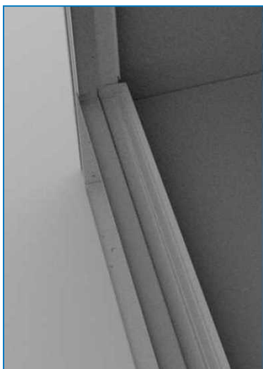
Gouttière de recueil de l'eau
