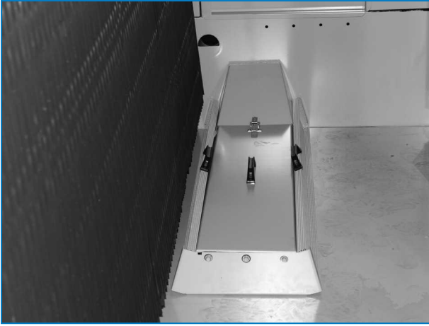
Balsa de agua fría y filtros de la balsa
