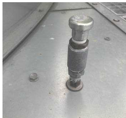
Évent sur plate-forme de ventilateur
