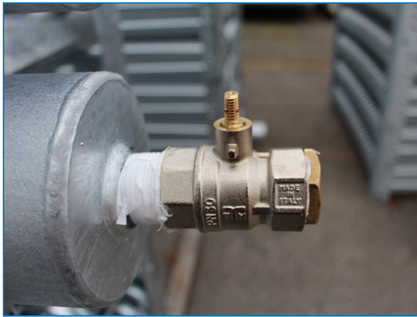
Raccord de batterie supérieure avec vanne de détente sur les tours de refroidissement à circuit fermé avec raccords supérieurs à DN 100.
