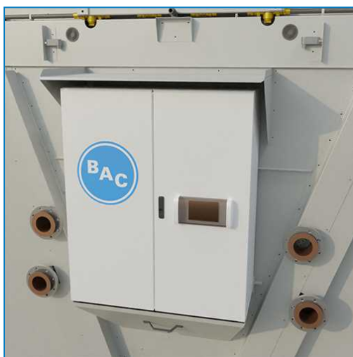
Quadro di comando
